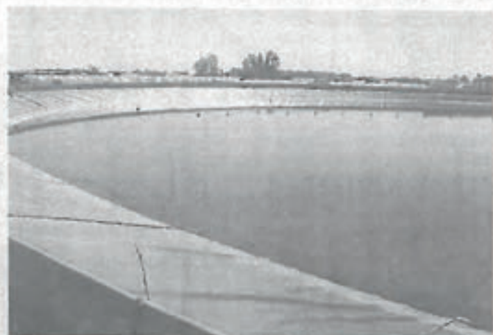
Balsa de regulación de la comunidad de regantes El Fresno, en Huelva.
